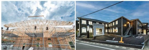
新設住宅工法による特建事業で年30棟の実績を持つセルコホーム(左は大スパン大型倉庫、右はツーバイフォー工法新設住宅)
